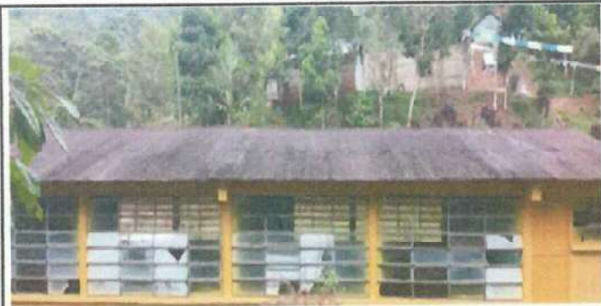
Foto 3: Se ha identificado que los vidrios de las ventanas se encuentran en mal estado, la rotura o desgaste de los vidrios puede representar un riesgo para los estudiantes.
