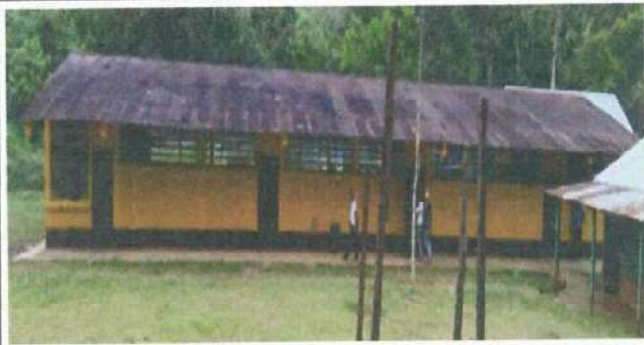
Foto 1: Se evidencia el mal estado de la cubierta del techo del establecimiento, lo que compromete la seguridad y protección de la infraestructura.
