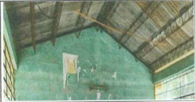
Foto 2: Se ha observado que la estructura del techo se encuentra en mal estado, lo que representa un riesgo para la seguridad y estabilidad del establecimiento.
